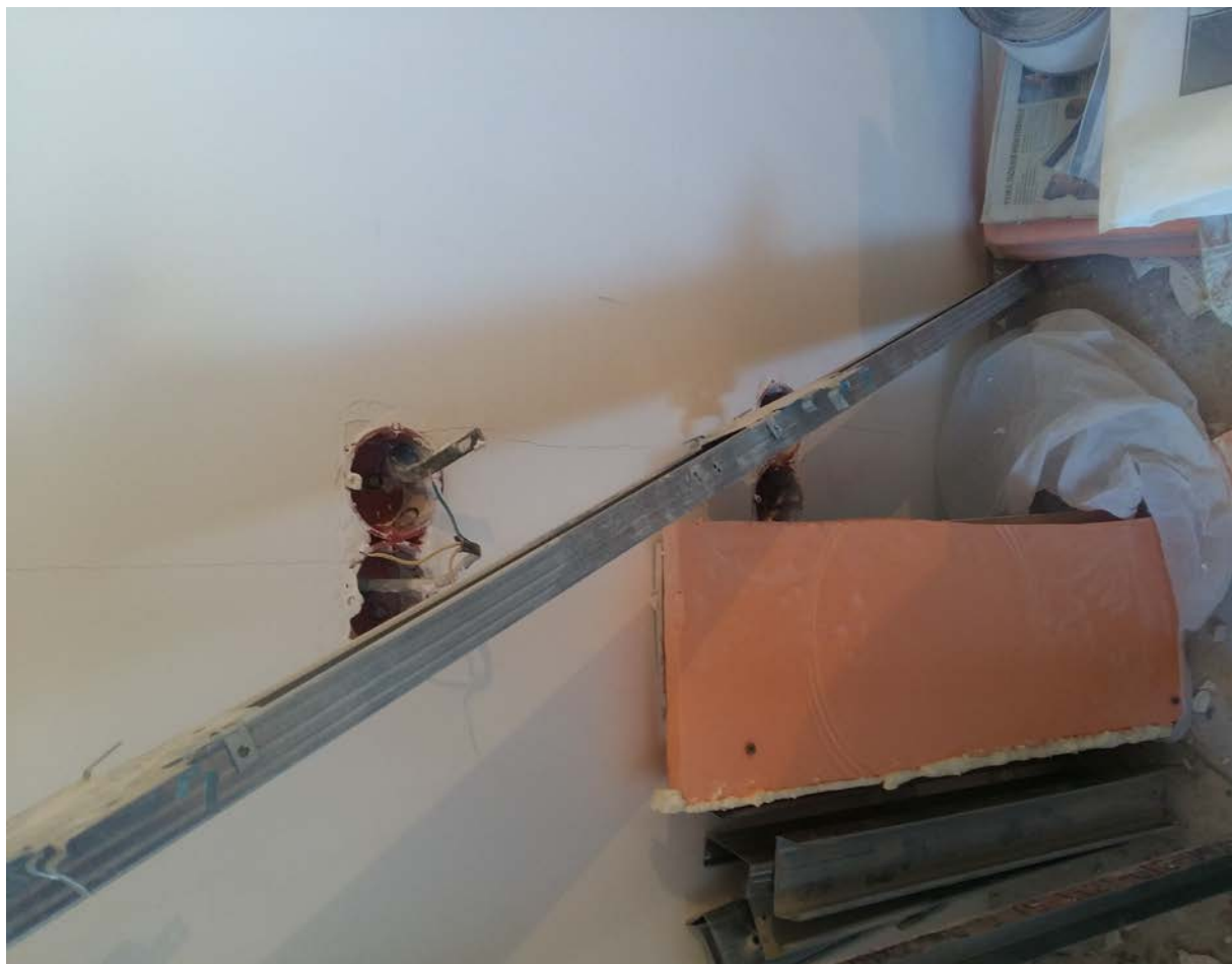
Фото1. Электроустановочные изделия, электротехническая разводка
