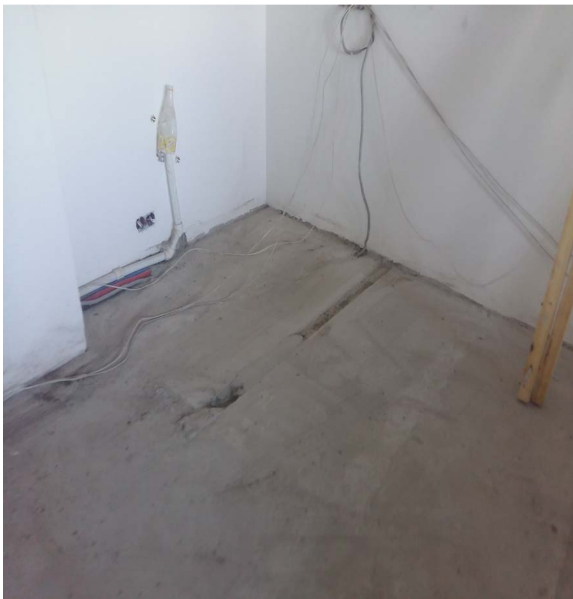
Фото 3 Электроустановочные изделия, электротехническая разводка
