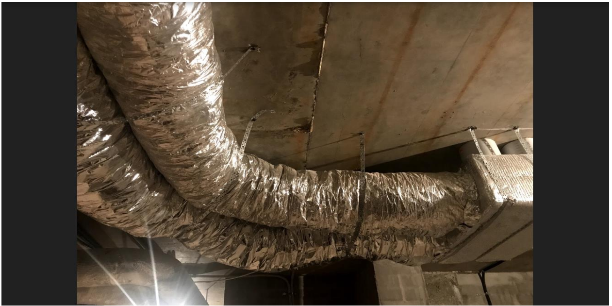
Провисание гибких воздуховодов.
