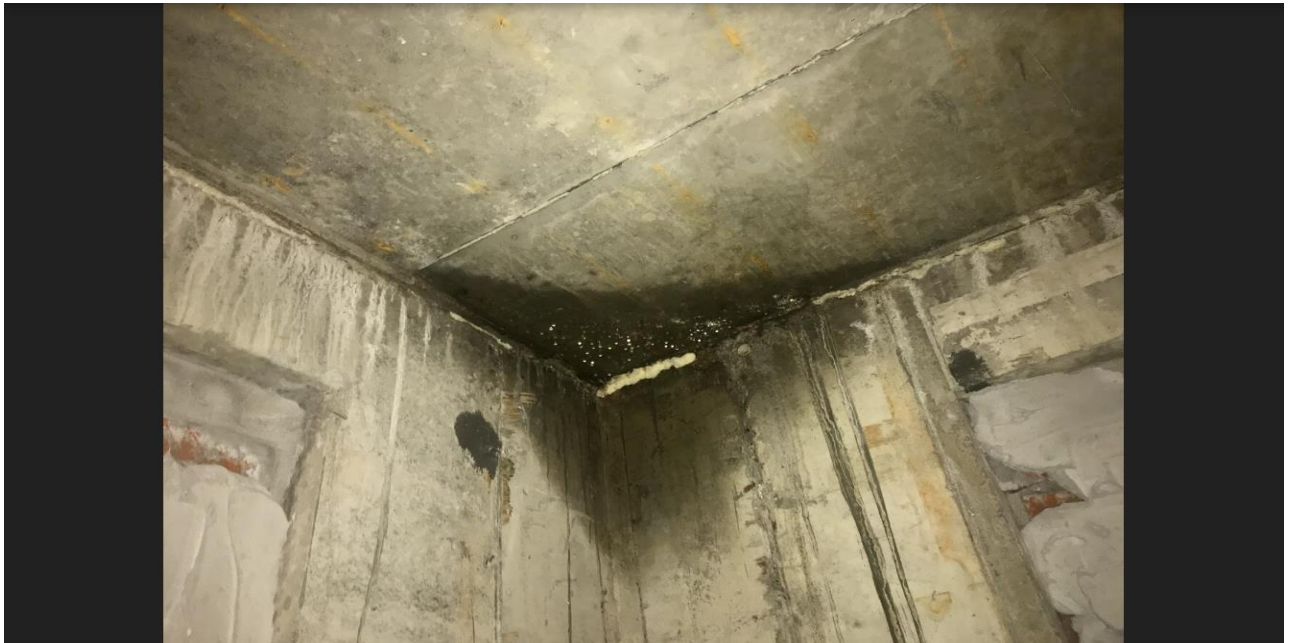
Конденсат на поверхности стен в подвале
