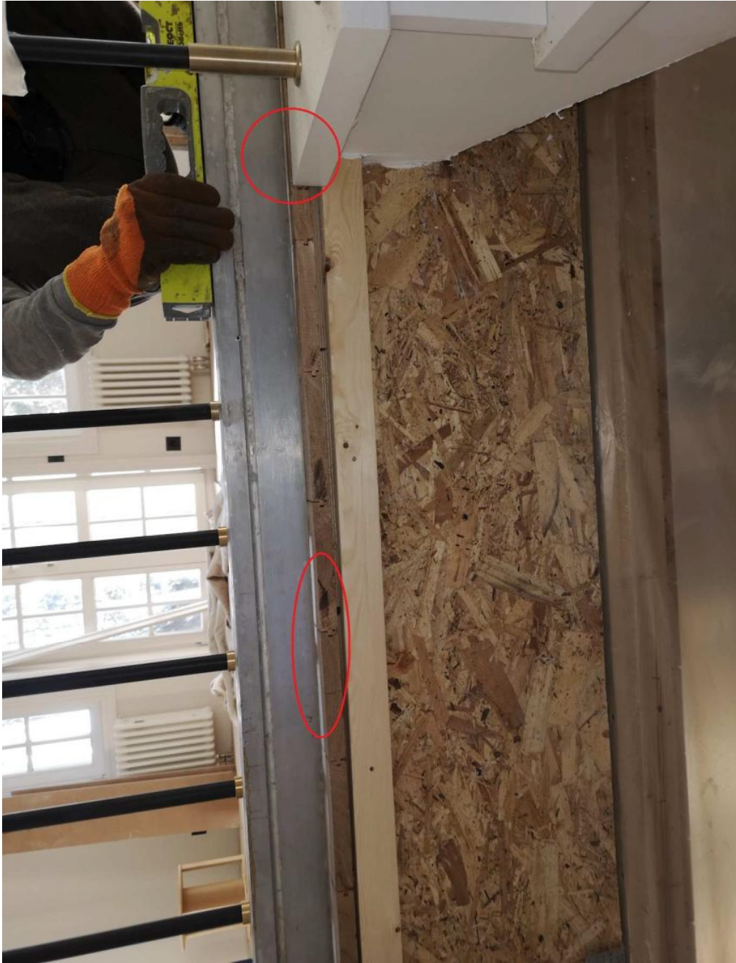
Дефекты укладки паркетной доски в холле 2-го этажа
