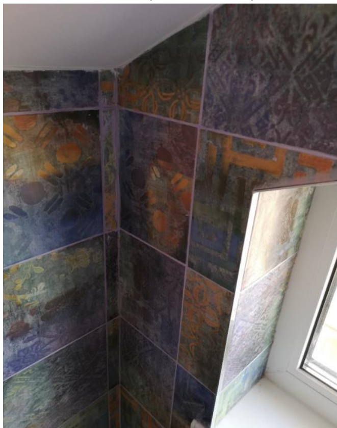
Некачественная затирка плитки в с/у, 13.06.2018.
