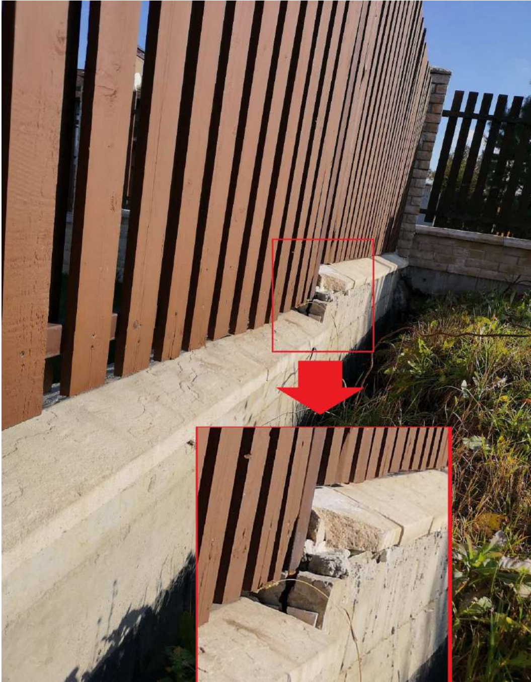
Поврежденная паралетная крышка.
