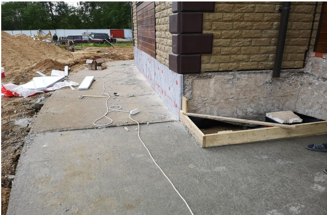
Неровности на отмостке до 15 мм, 07.06.2018.
