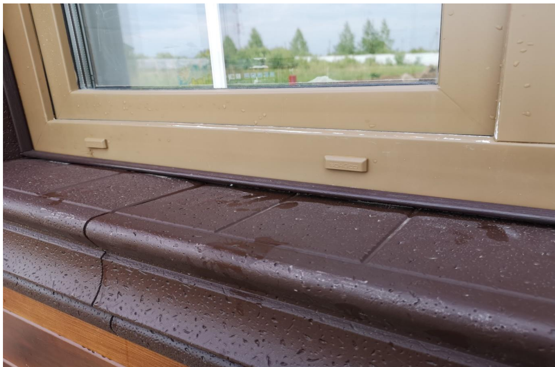
Зазор в месте примыкания подоконника.
