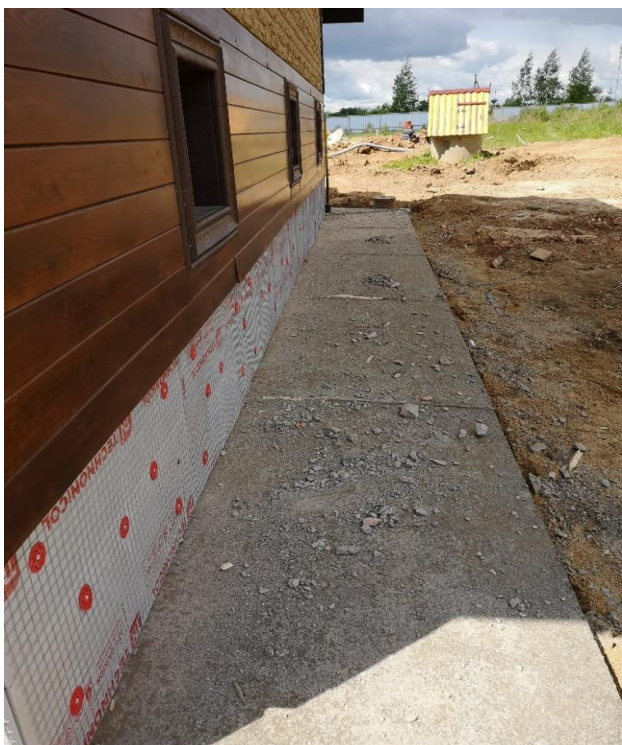
Верхний слой отмостки размыт, 07.04.2018.
