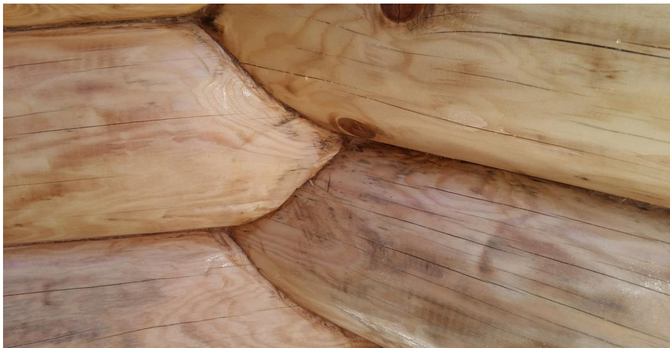
Следы грибка на фасаде.
