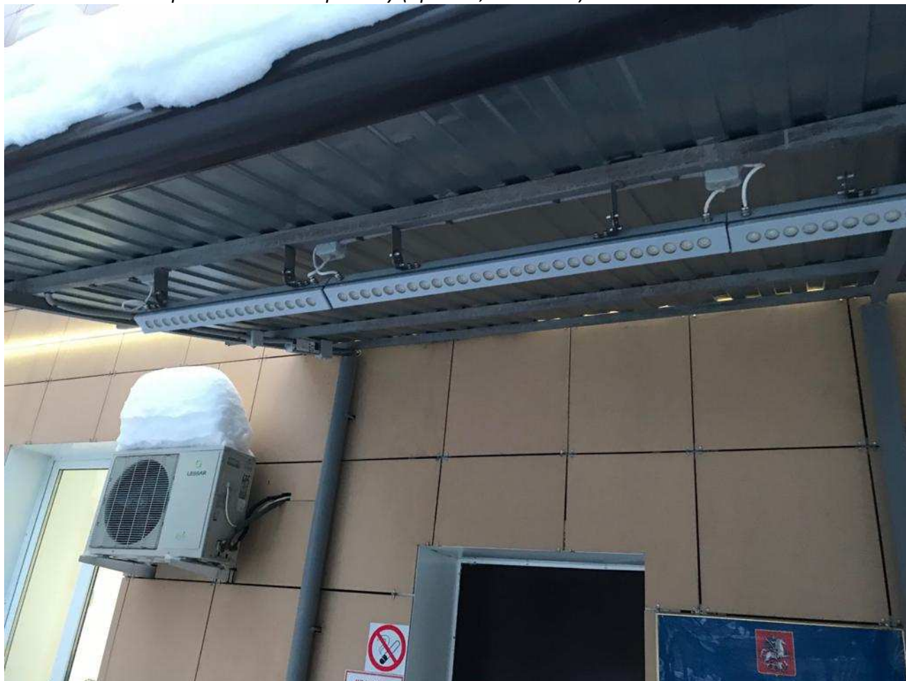
Инфотабличка, дефекты на фасаде.
