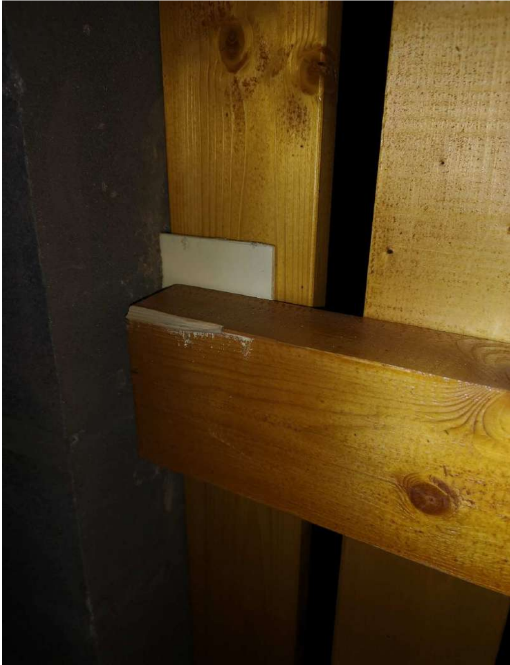
Повреждение деревянного элемента.
