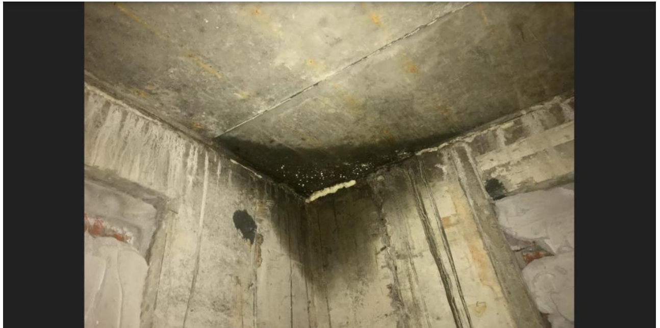
Конденсат на поверхности стен в подвале
