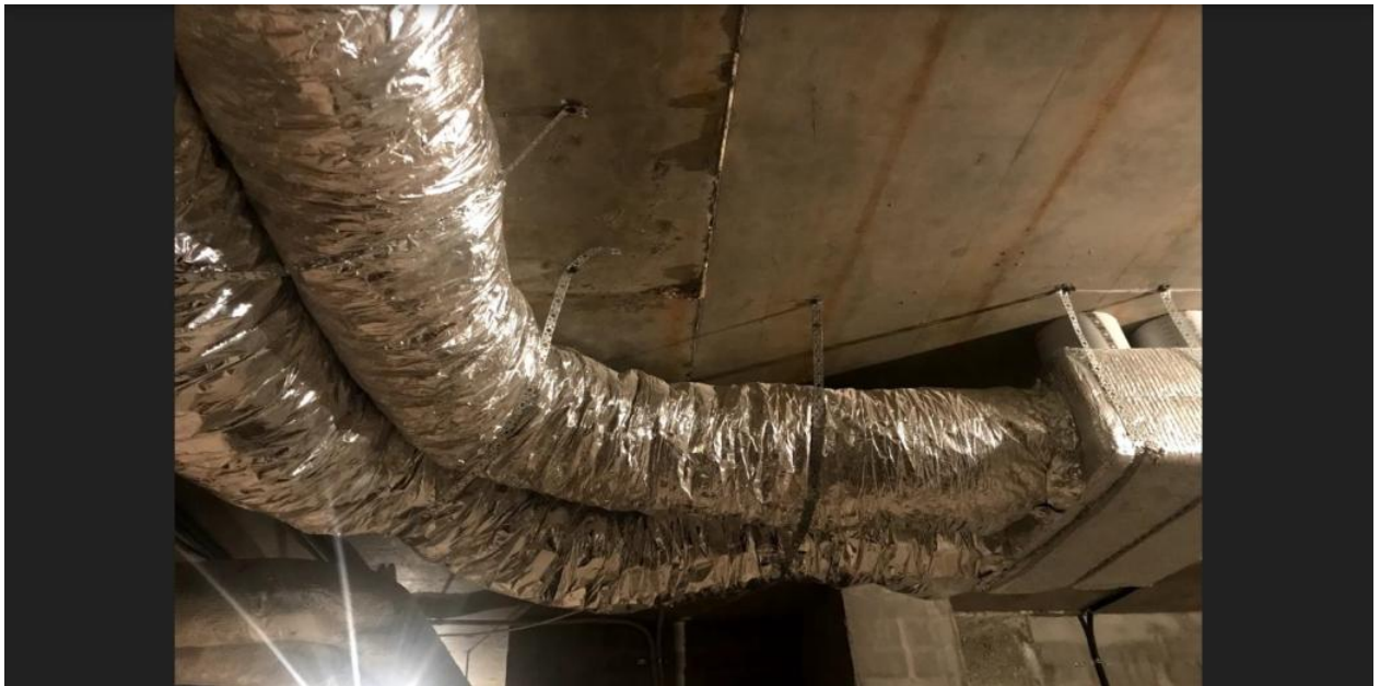
Провисание гибких воздуховодов.
