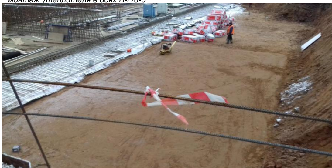
Устройство песчаной подушки с трюмованием в осях В-Г/8-5, монтаж утеплителя в осях В-Г/8-5
