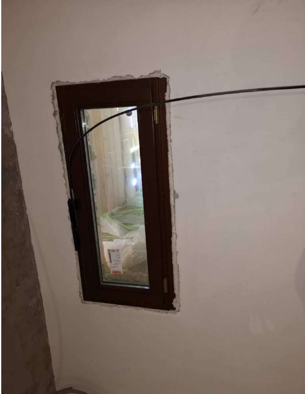
Окна цоколя в зоне промерзания стен.
